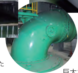
巨大な送水管
